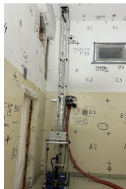
Testaufbau einer Fräseinheit für die Entschichtung (hier am Standort Stade)
